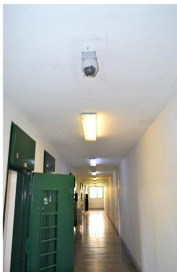
Telecamera n°71 isolamento lato B
